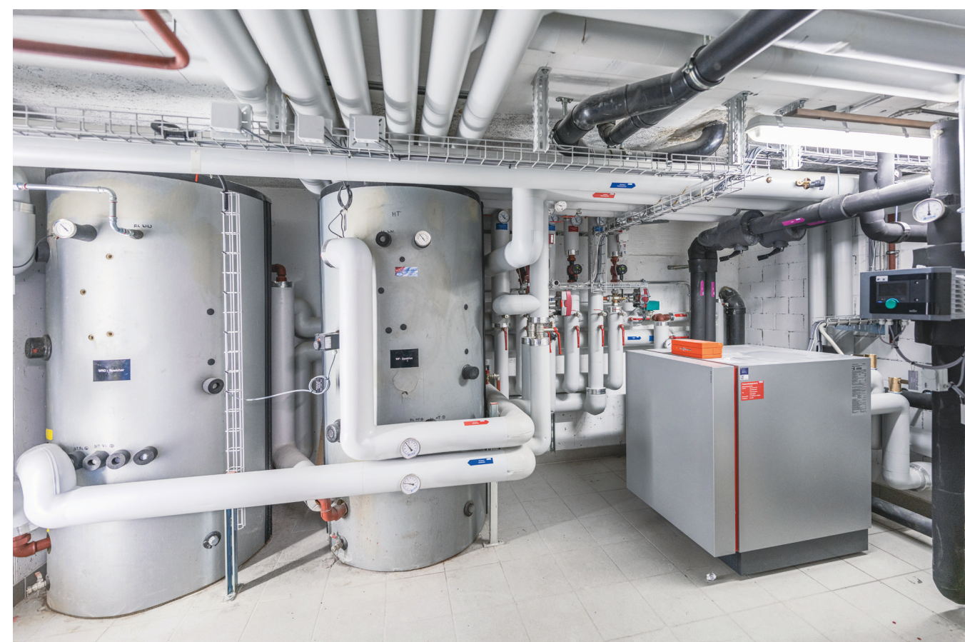
Die neue Wärme-Erzeugung mit Warmwasser-Aufbereitung
