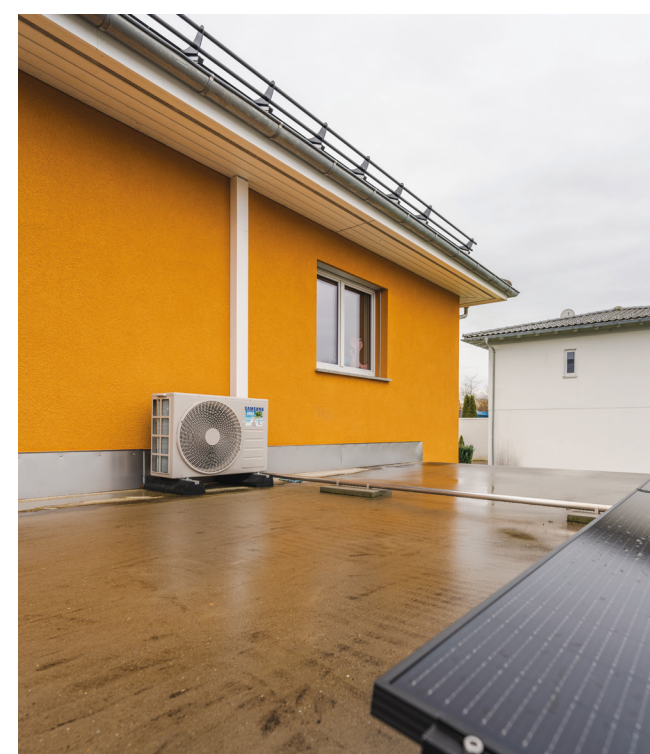
das Aussengerät für die Kälteerzeugung
